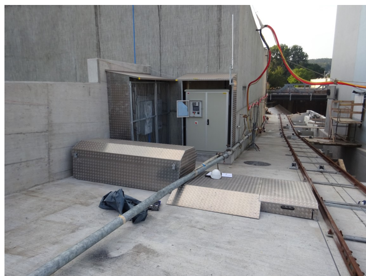
Spanngewicht, Steuerschrank und Antrieb sind mit Alu-Warzenblech verkleidet.
